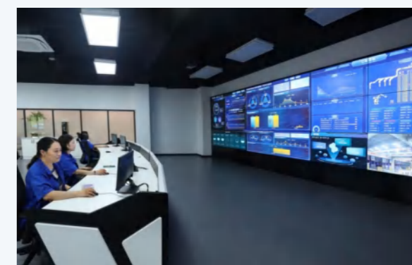
智能科技产业基地中控室
