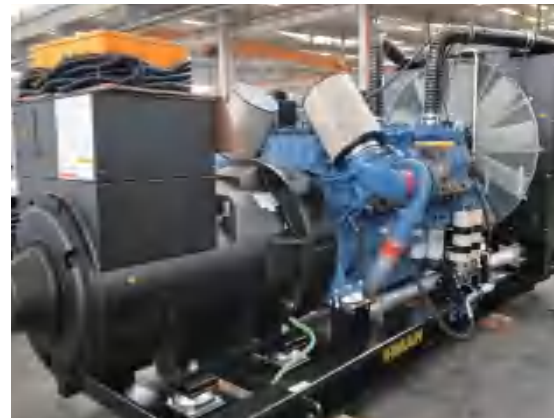
2022北京冬奥会备用电源项目
