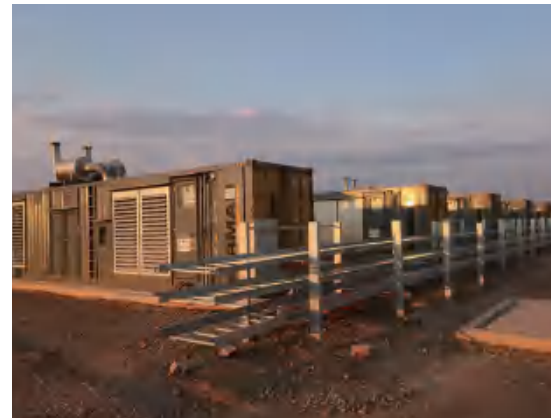
刚果金矿业备用电源项目
