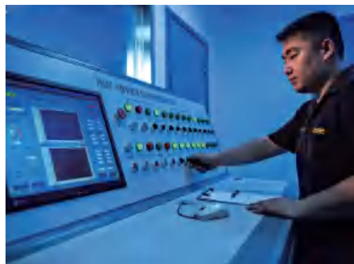
发电设备检测中心
